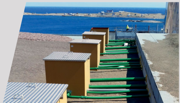
Chaufferie générale, France
