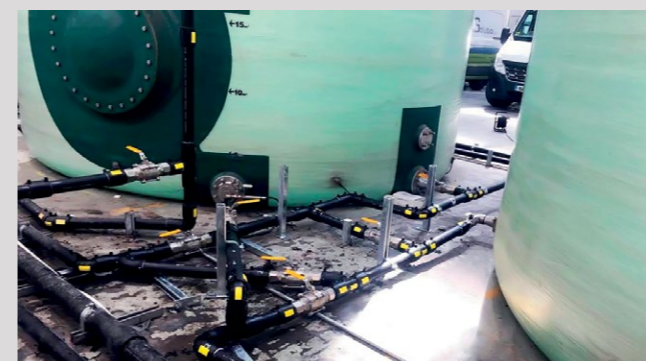
Instalaciones de producción de Adblue de Maxol – Ireland
