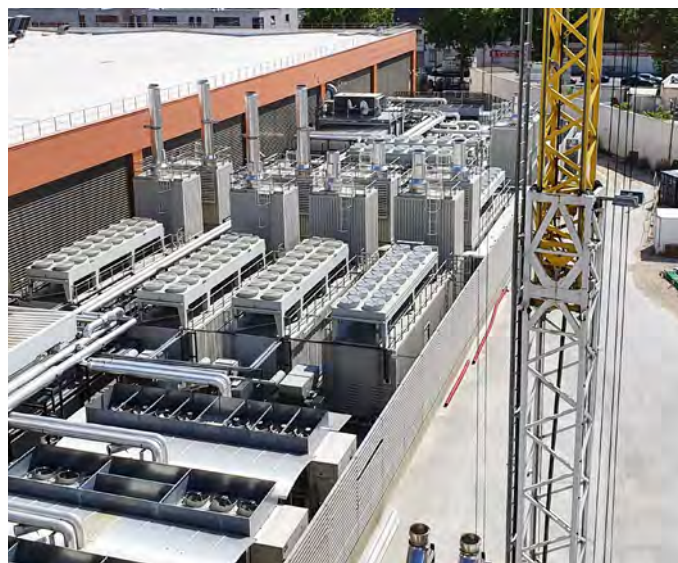
Les différentes tranches de ce data center utilisent chacune des groupes électrogènes par blocs disjoints
