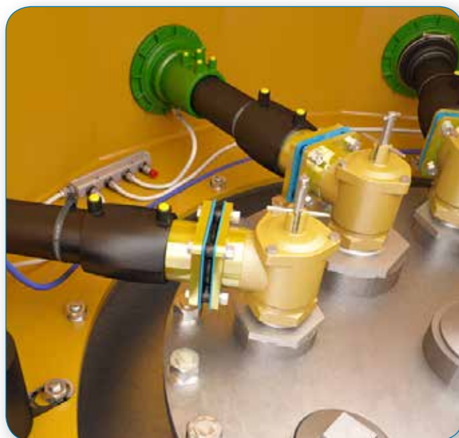
L'unité de détection de fuite doit être reliée à un KP T ou un KP TM.
