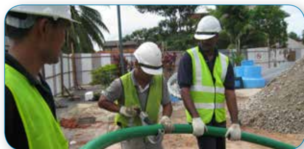
Une personne doit maintenir le tuyau et une autre doit faire la coupe.
