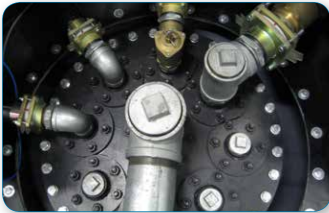
Branchements sur les plateaux de cuve avec raccords à bride et vannes de fermeture.
