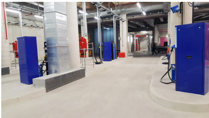
RATP richiedeva un sistema di tubazioni con una portata elevata per fornire rapidamente diesel alla propria flotta di autobus
