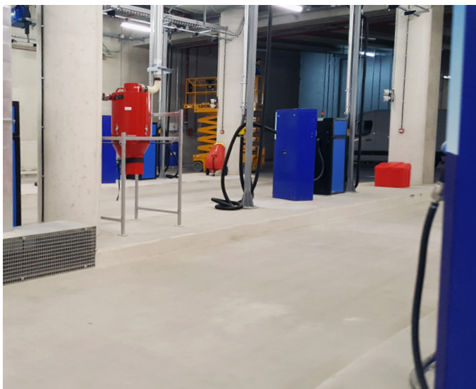
Poiché i punti di riempimento erano installati all'interno di un garage, era essenziale un sistema a permeazione zero senza perdite
